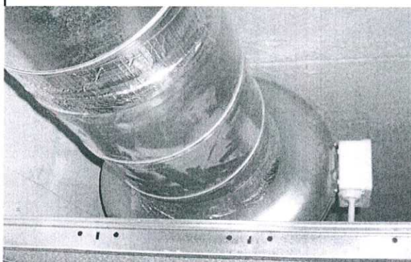
5.att. Ventilācijas iekārta (nosūce).
